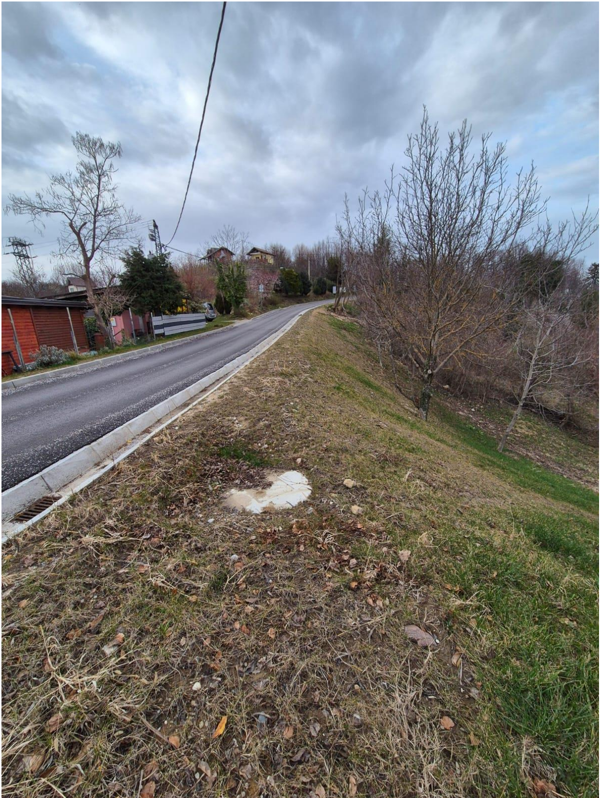
Slika.32. prikaz sadašnjeg stanja saniranog klizišta 2
