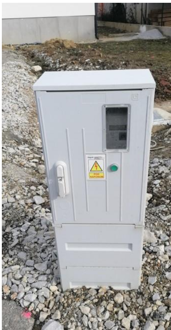
Slika 7. KPMO (kućni priključni mjerni ormar)
