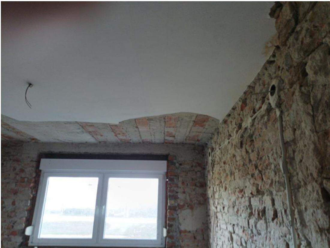
Slika 3.7 – Zatečeno stanje zidova
