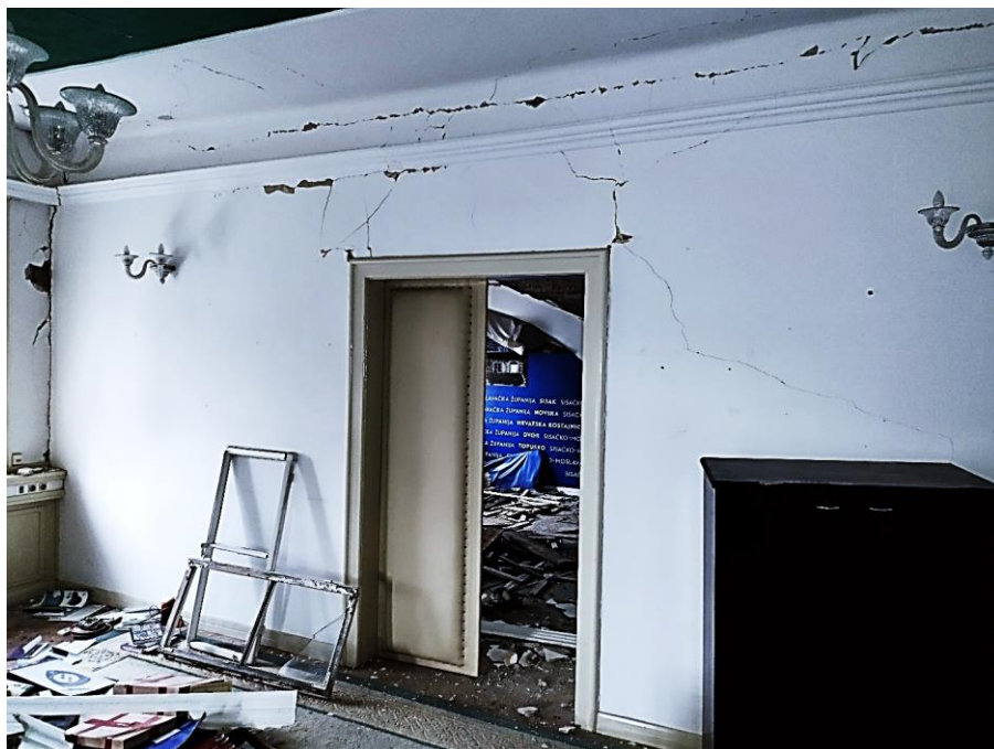
Slika 5.15 Prostorija 2. Dijagonalne pukotina na pregradnom zidu
