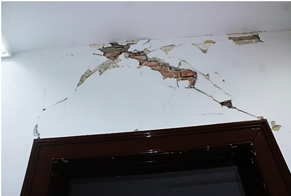
Slika 5.13 Prostorija 15. Oštećenje nadvoja
