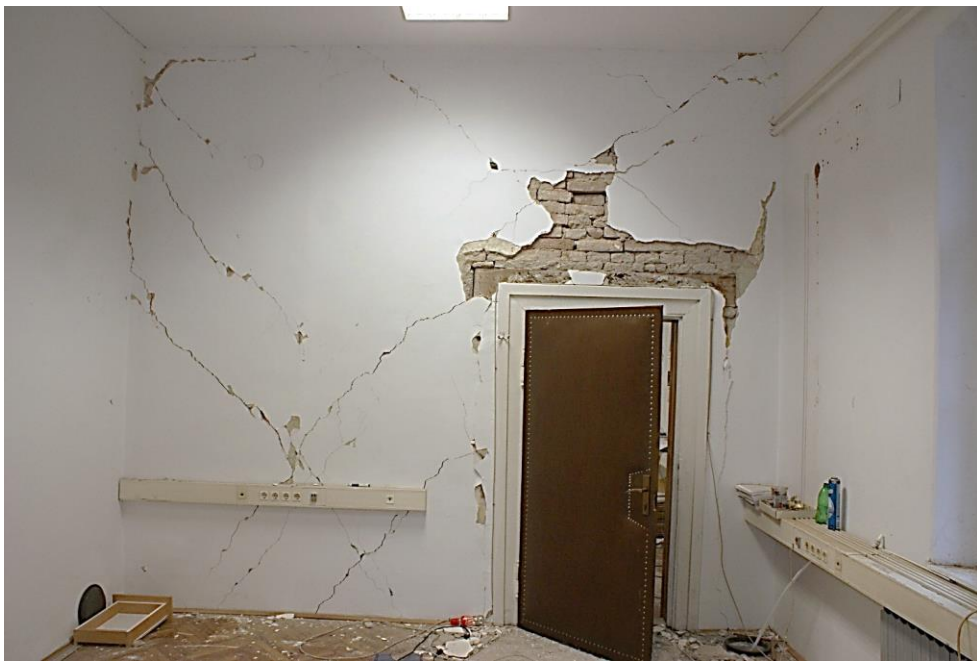
Slika 5.14 Prostorija 25. Rasprostranjene dijagonalne pukotine zida
