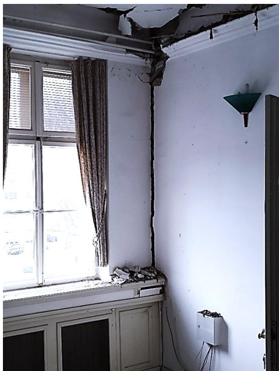
Slika 5.17 Prostorija 5.1. Pukotina na mjestu spoja pregradnog i nosivog zida
