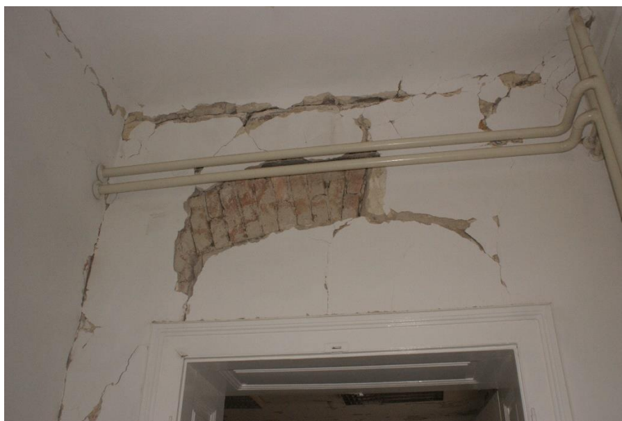
Slika 5.9 Prostorija 1. Pukotine na nadvoja
