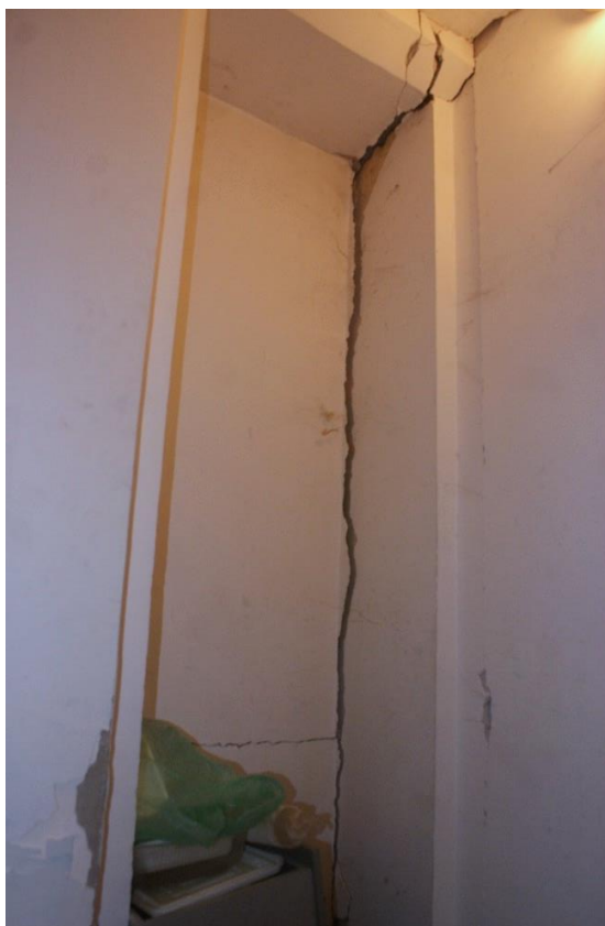
Slika 5.7 Prostorija 24. Pukotina na spoju dva nosiva zida
