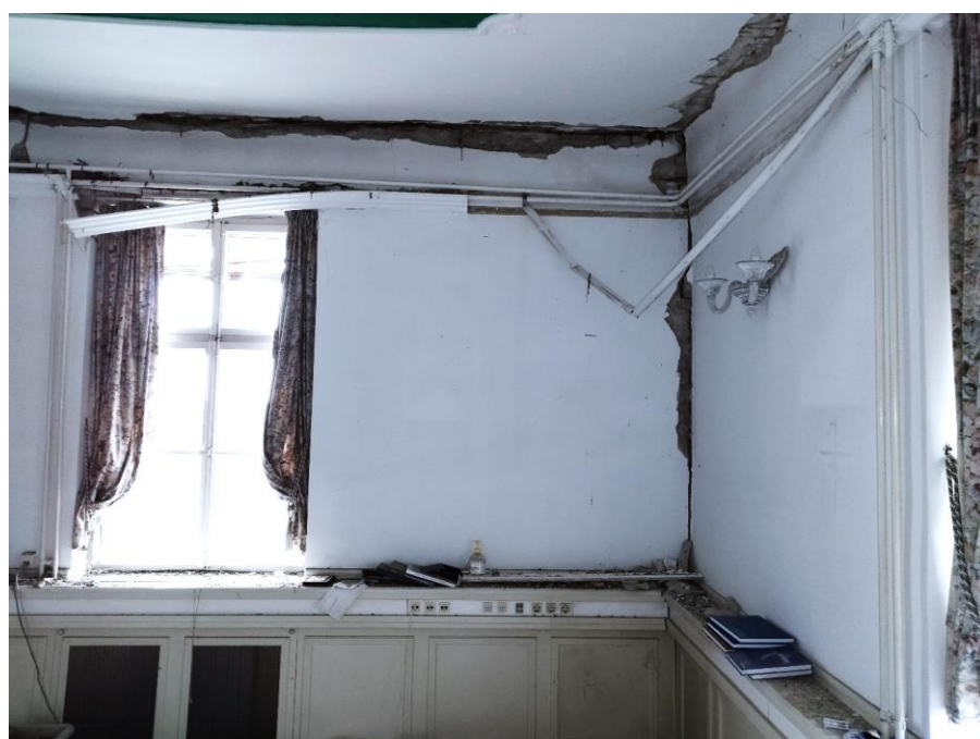
Slika 5.16 Prostorija 4 pukotina na mjestu spoja 2 zida i međukatne konstrukcije
