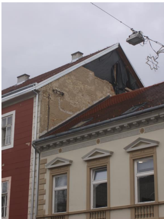
Slika 5.23 Urušeni dio zabatnoga zida
