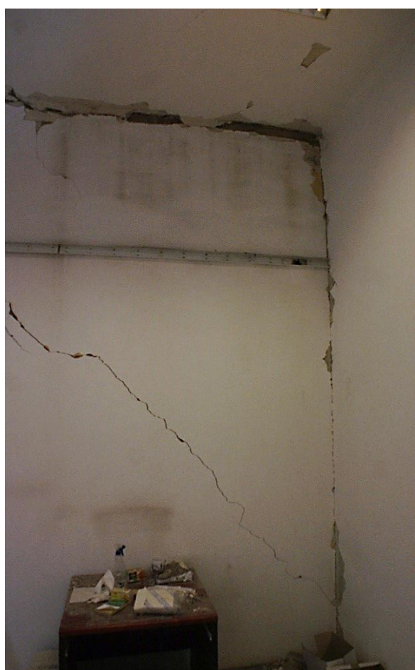
Slika 5.10 Prostorija 2. Dijagonalna pukotina zida
