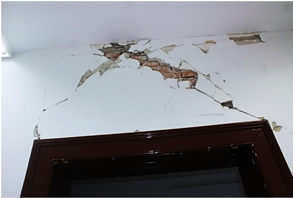
Slika 5.13 Prostorija 15. Oštećenje nadvoja
