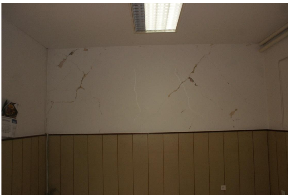
Slika 5.8 Prostorija 26. Pukotina na pregradnim zidovima
