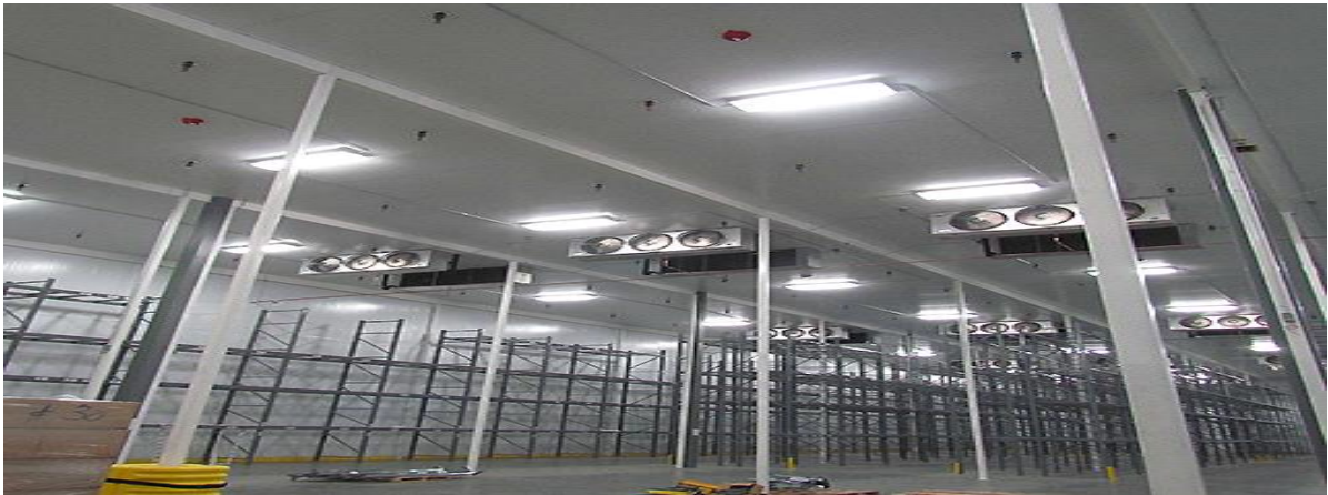
Slika br.5 Kondicionirano skladište
