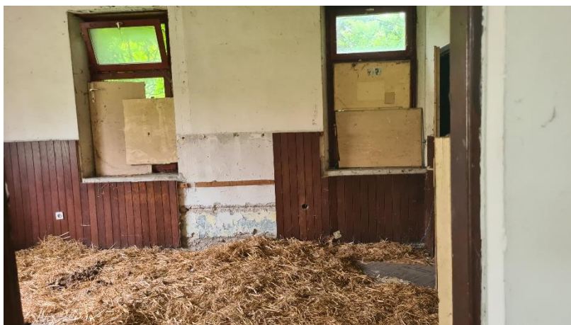
Slika 19. Prikaz vidno zapuštenog interijera testne građevine
