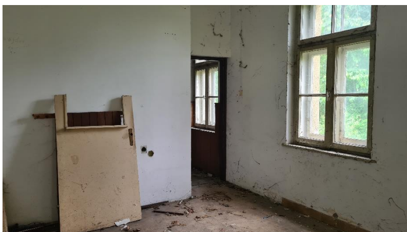
Slika 20. Prikaz oštećenja podova testne građevine
