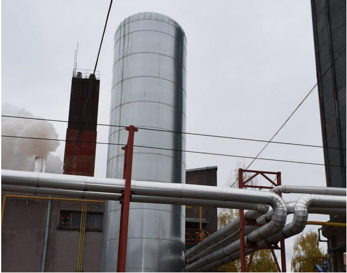
Slika 1 - Akumulacijski spremnik 70 m 3 u Lepoglavi [2]
