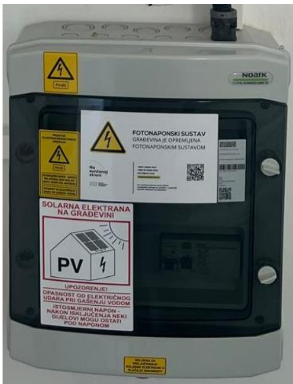
Slika 3.11. Pogled na priključni ormar – izvana
