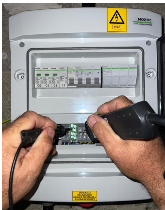
Slika 5.6. Ispitivanje otpora uzemljenja
