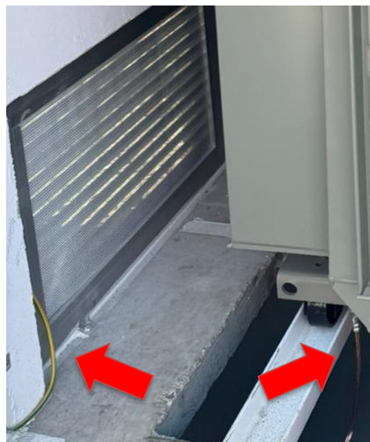
Slika 18. Zaštitno uzemljenje na vent. otvoru
