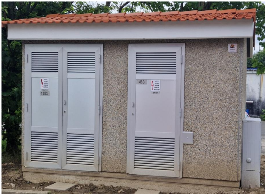
Slika 10. Vanjski izgled TS-a – naprijed
