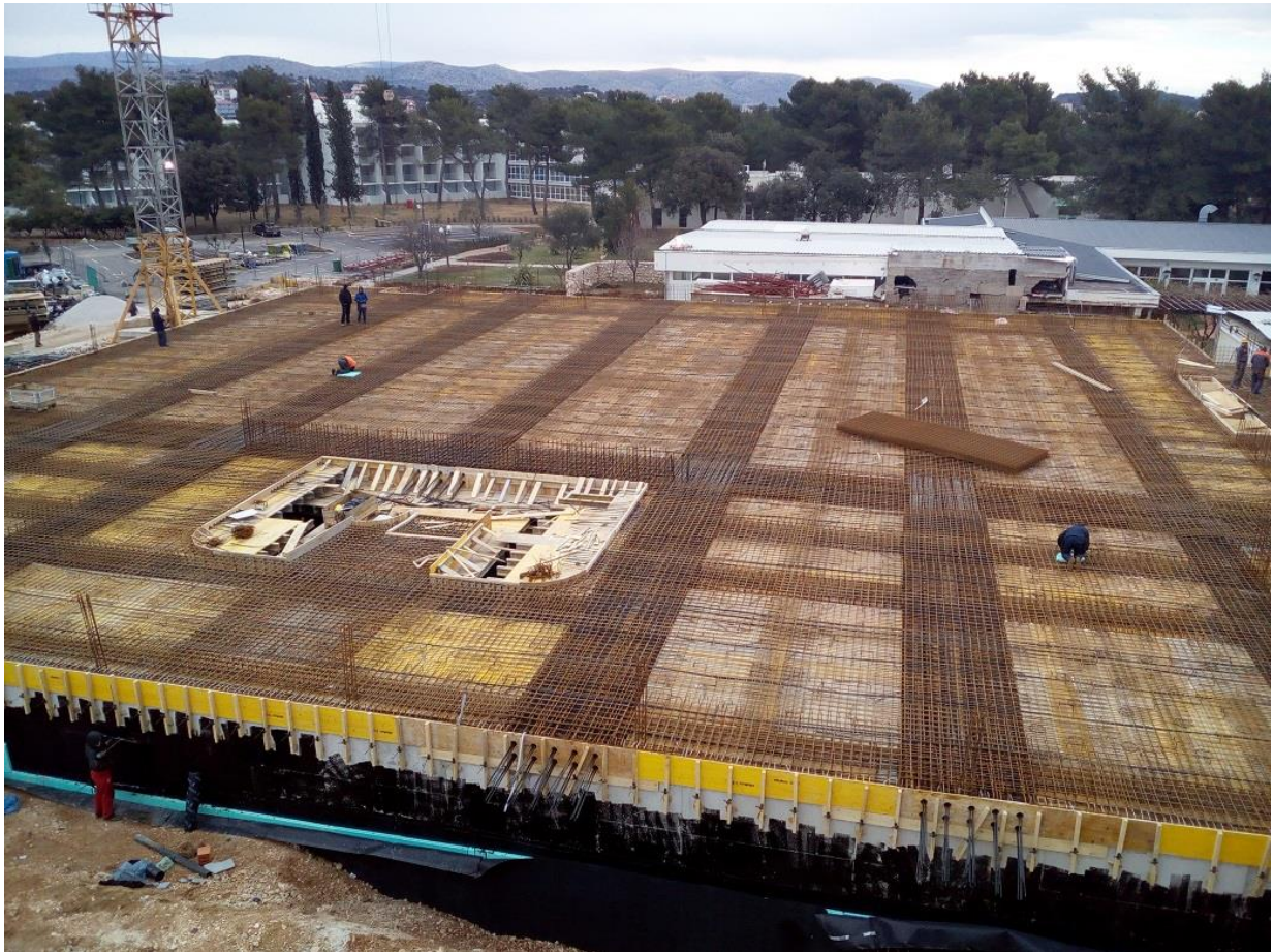
Slika 2.7 Aktivna usidrenja – primjer na izgradnji dvorane u sklopu hotela Solaris u Šibeniku (Izvor: [4])
