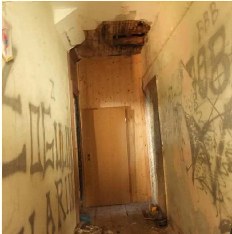
Slika 23. Stropno oštećenje u hodniku na drugom katu
