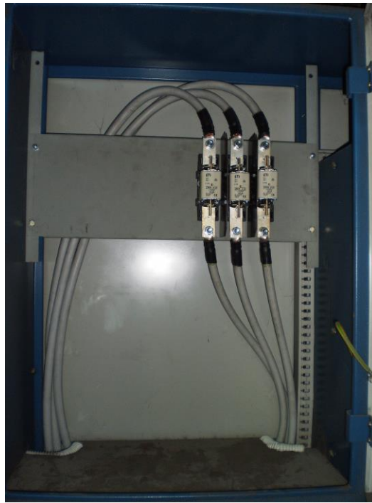
Slika 4.12 Spoj kompenzacije u glavni razvodni ormar
