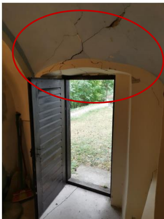
Slika 39: Pukotine na svodu ulaznog prostora
