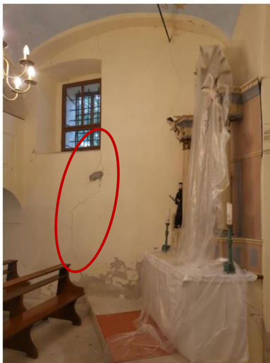
Slika 35: Pukotine ispod prozora na sjevernom pročelju (Izvor: vlastita fotografija autora)
