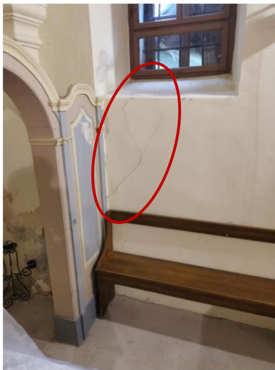
Slika 38: Pukotine ispod prozora na južnom pročelju
