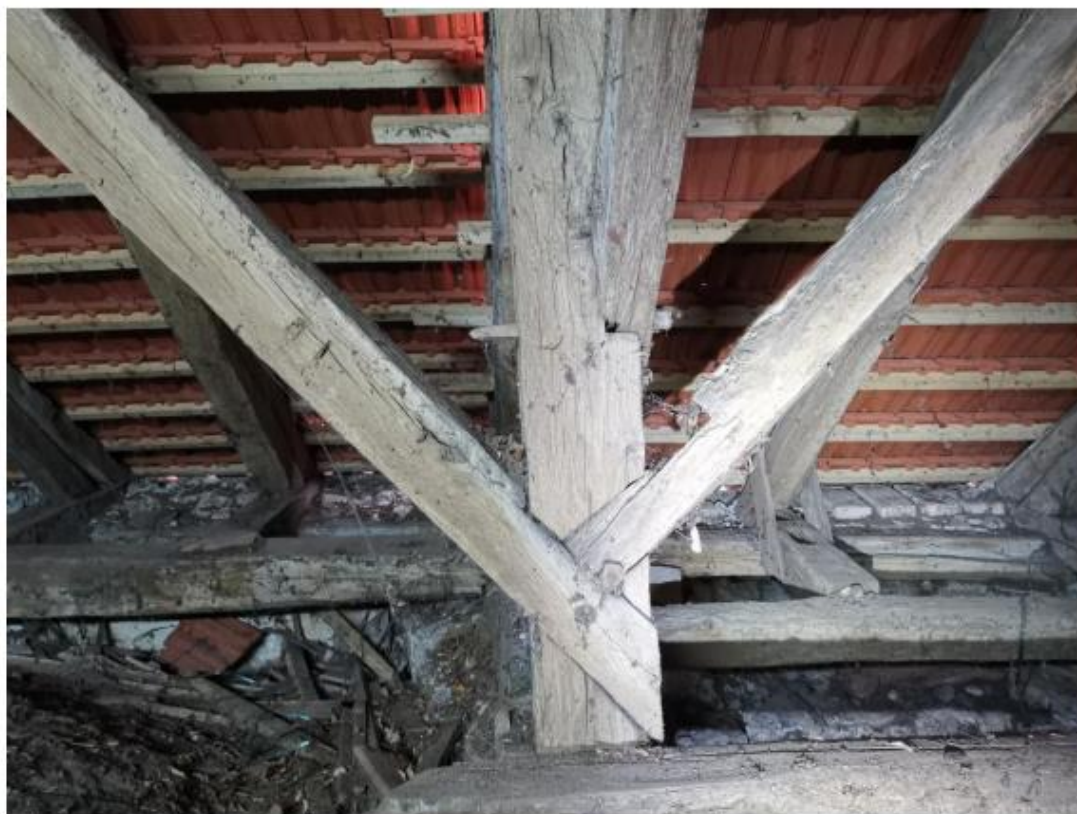
OSLABLJENI SPOJEVI DRVENE KROVNE KONSTRUKCIJE
