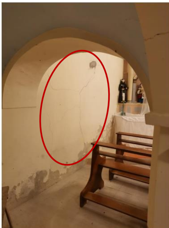
Slika 34: Oštećenja zida na sjevernom pročelju (Izvor: vlastita fotografija autora)
