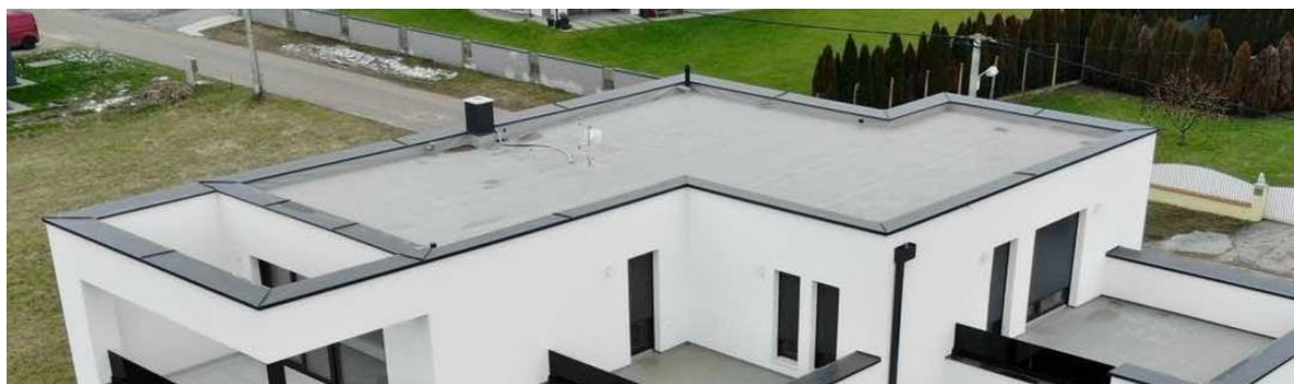
Slika 3.5.1. Izgled TPO folije na krovu
