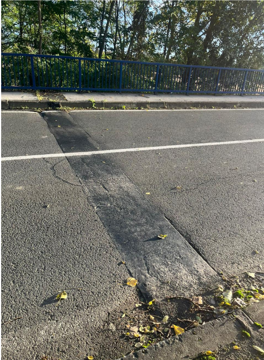
Slika 33 Bitumenska kontinuirana prijelazna naprava na nadvožnjaku u Maloj Subotici, (10.10.2024.)
