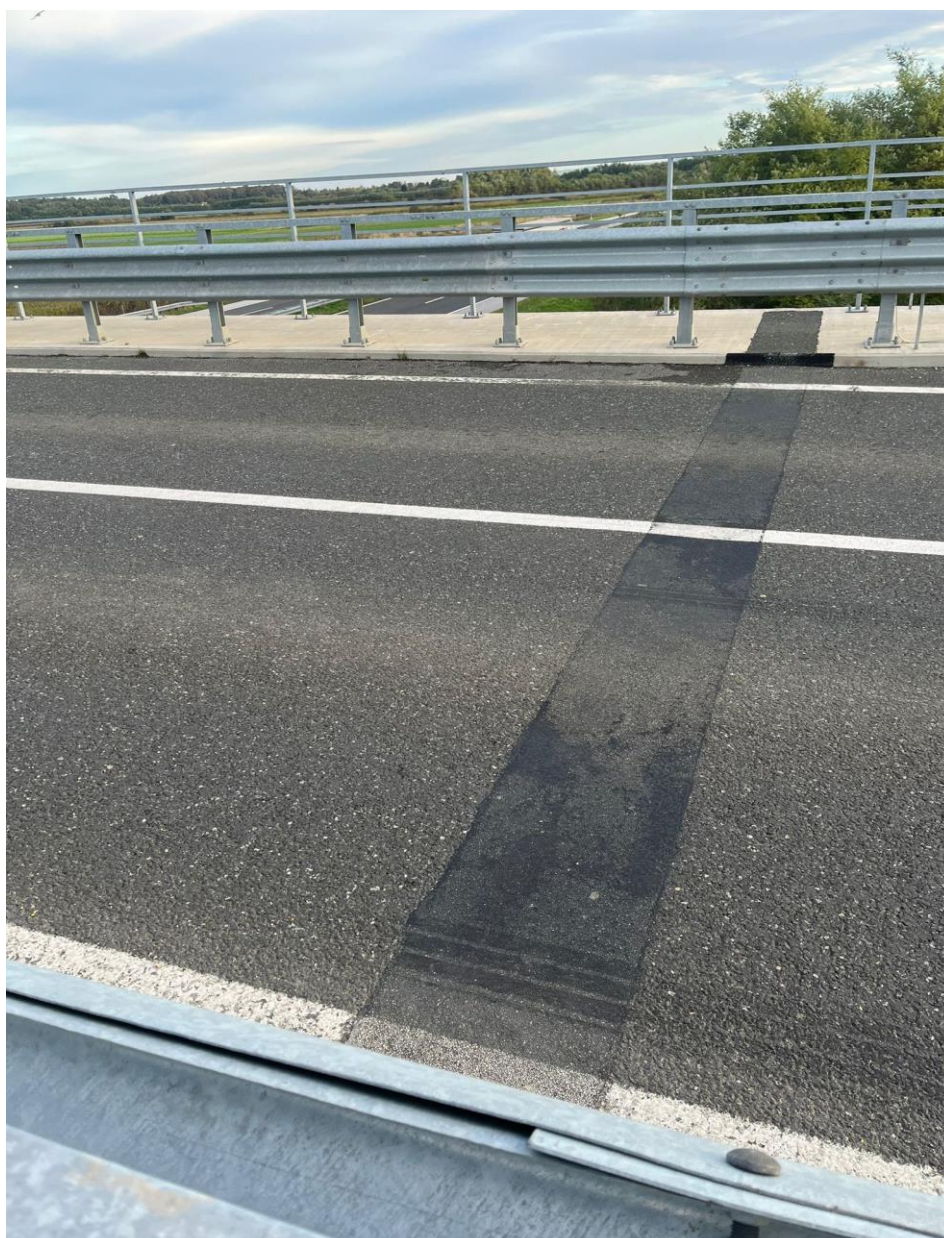
Slika 35 Bitumenska kontinuirana prijelazna naprava na nadvožnjaku u Palovcu, (10.10.2024.)
