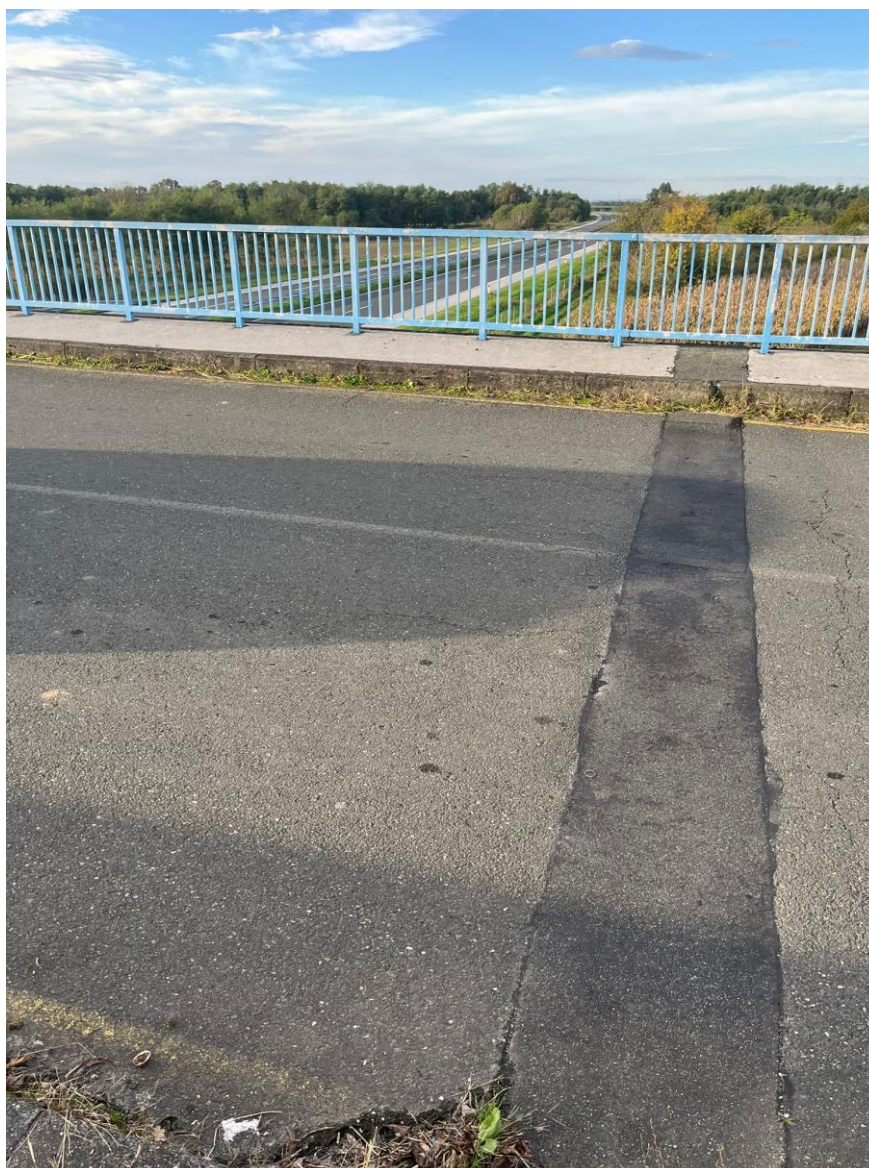
Slika 36 Bitumenska kontinuirana prijelazna naprava na nadvožnjaku u Držimurcu, (10.10.2024.)
