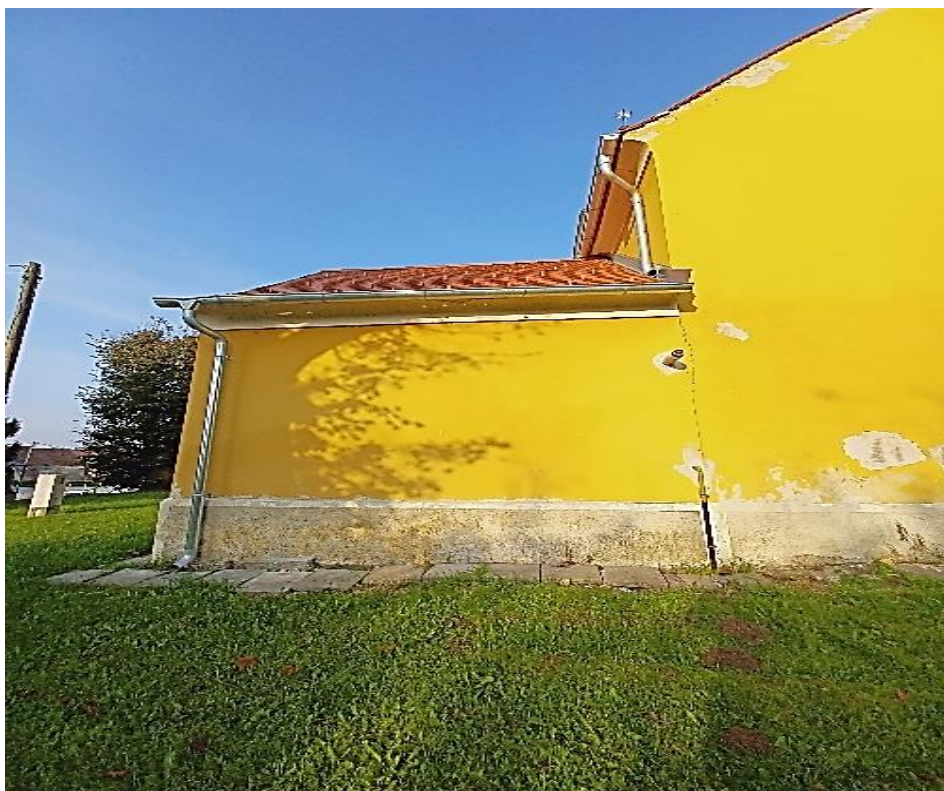
Slika 25. Prikaz oštećenja istočnog pročelja
