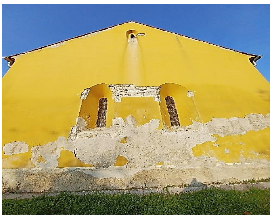
Slika 26. Prikaz oštećenja istočnog pročelja
