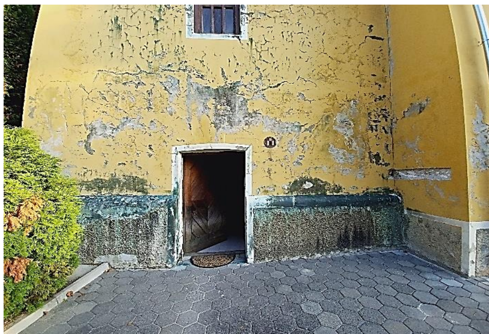
Slika 14. Prikaz oštećenja južnog pročelja
