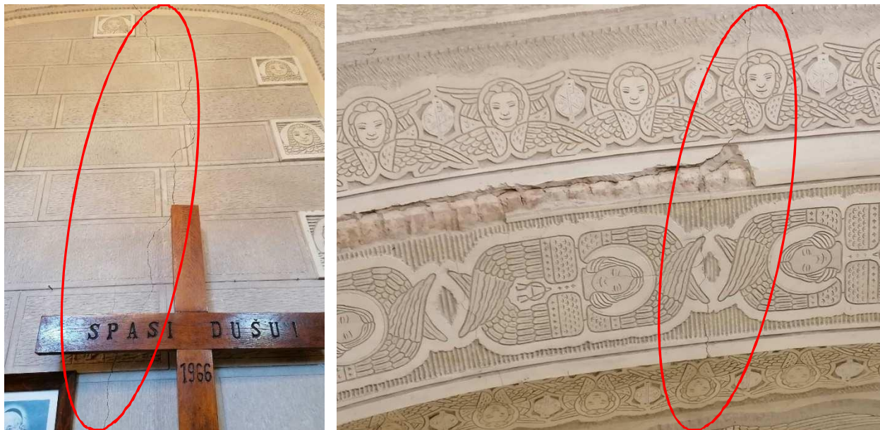
Slika 42. Pukotina sjevernog zida kapele (zid sakristije)
