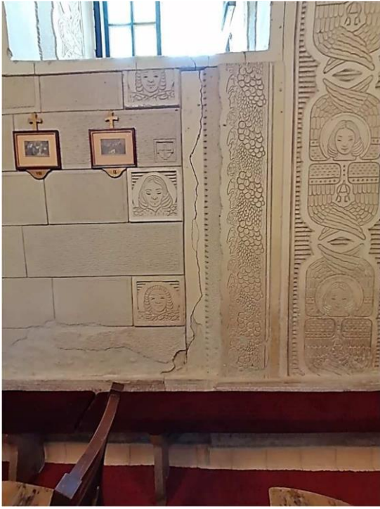
Slika 39. Oštećenje lijevog zida broda crkve
