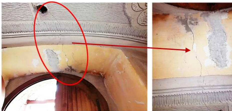
Slika 89. Pukotina na nadvoju ulaza, odnosno luku iznad ulaznih vratiju
