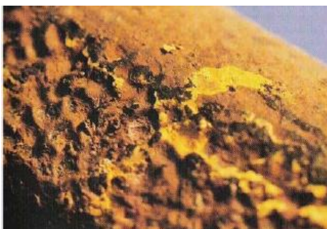
Slika 4.3 Primjer visokotemperaturne kemijske (plinske) korozije [12]
