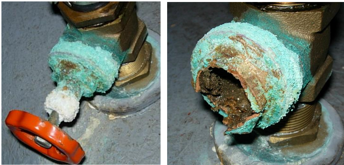
Slika 4.17 Uslijed decinkacije mjedi dolazi do puknuća ventila [31]
