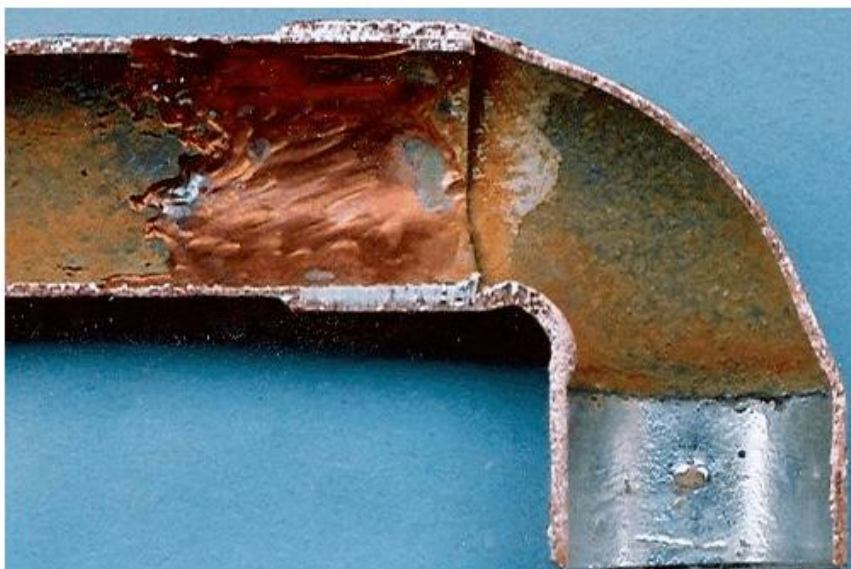
Slika 4.24 Primjer erozijske korozije unutarnje stjenke bakrenog cjevovoda [35]
