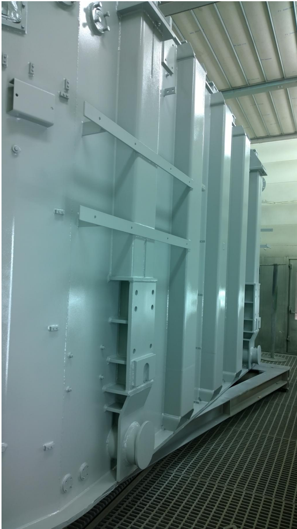
Slika 6.23 Izgled gotovog kotla
