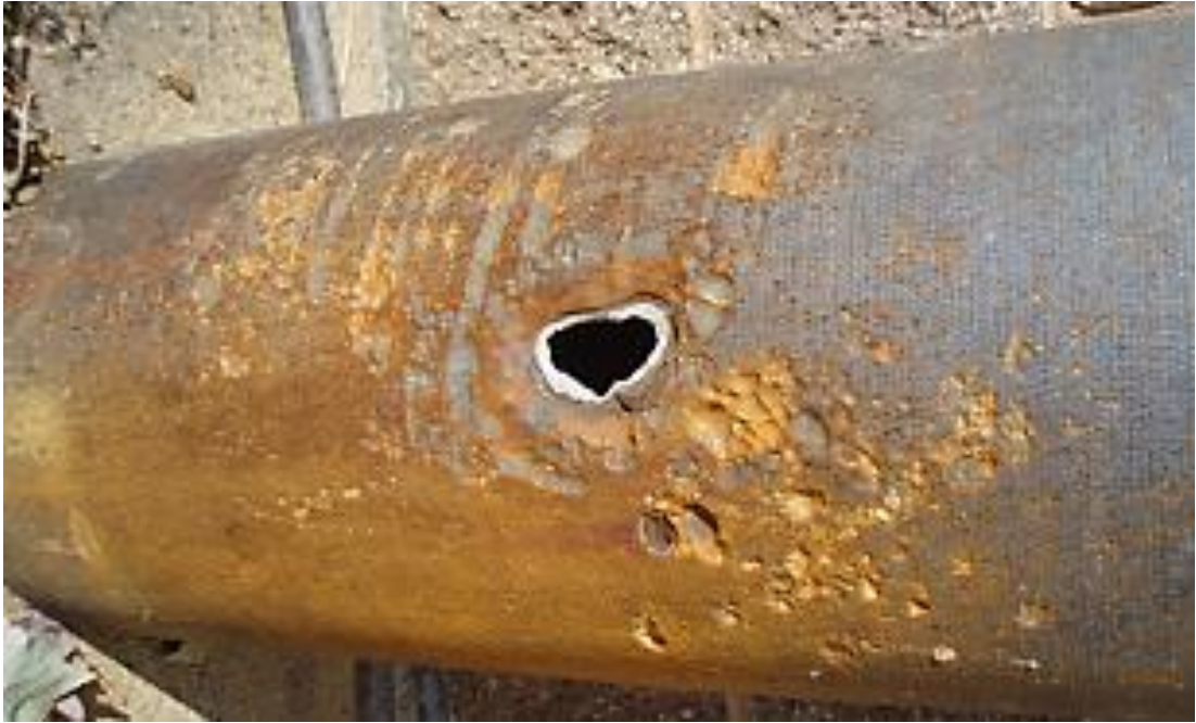
Slika 4.13 Primjer rupičaste korozije- probušeni cjevovod[24]
