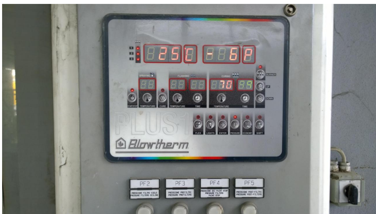
Slika 6.13 Postavljanje temperature za sušenje
