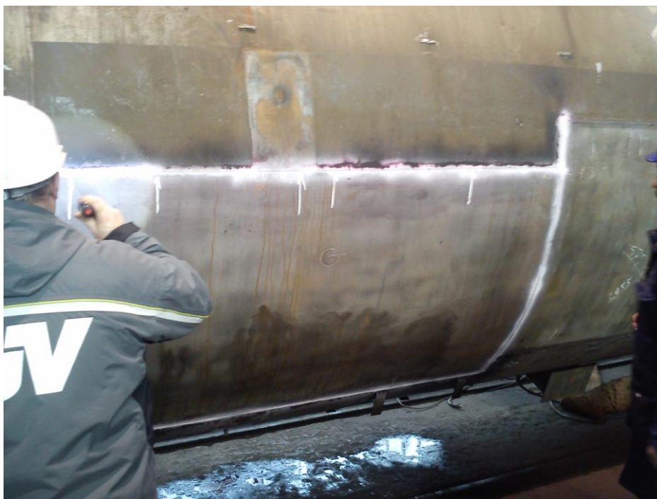
Slika 32. Pregled zavarenih spojeva nakon ispitivanja
