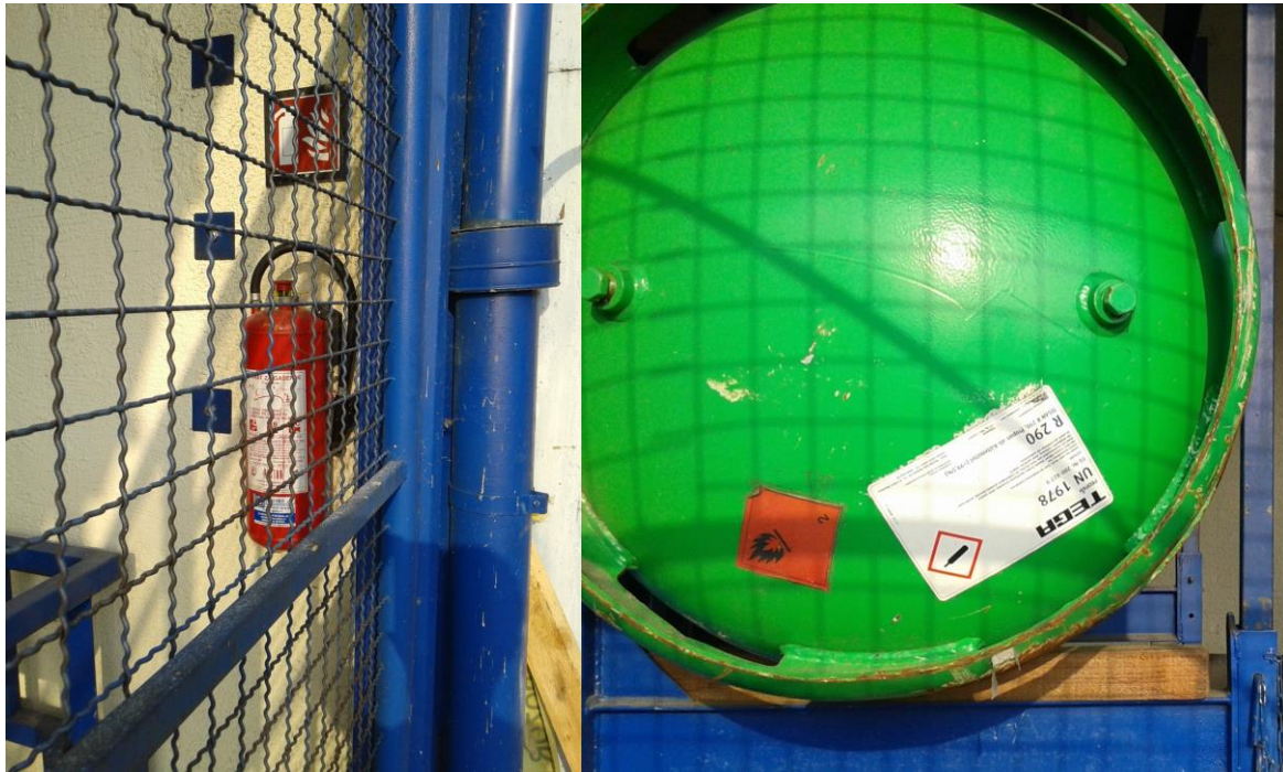
Slika 19. Aparat za gašenje požara i spremnik propana
