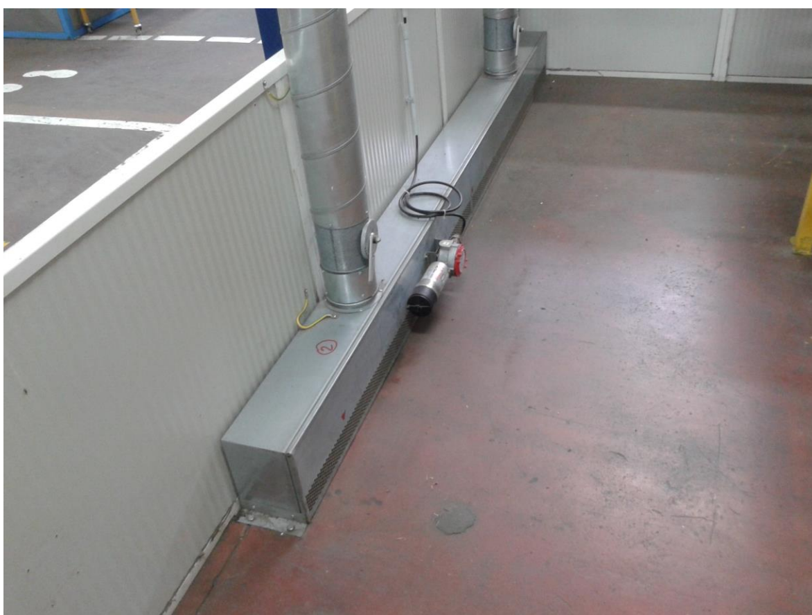
Slika 11. Osjetnik broj 1 za propan, i ventilacija
