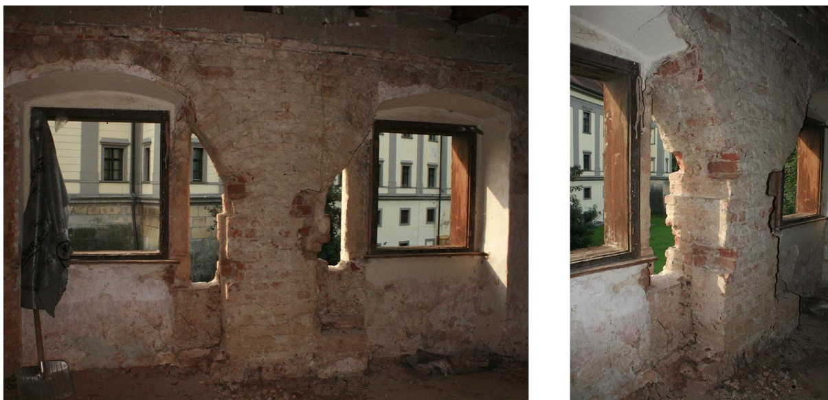
Slika 3.3. Oštećenje lukova na I.katu
