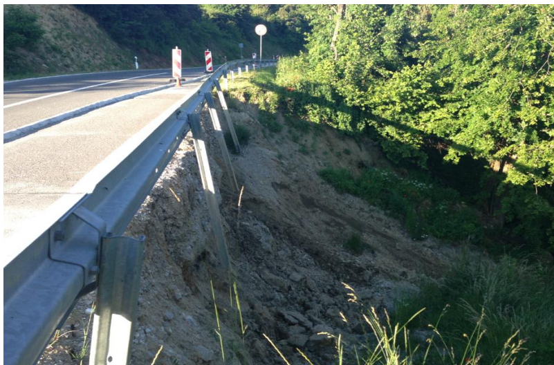
Slika 8.1 Državna cesta D22 – klizište „D22- Sudovec II.“
