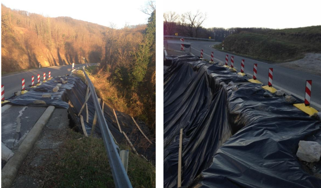
Slika 8.3: Klizišta: Kipišće I. i Kipišće II. na razmaku cca 30 m
