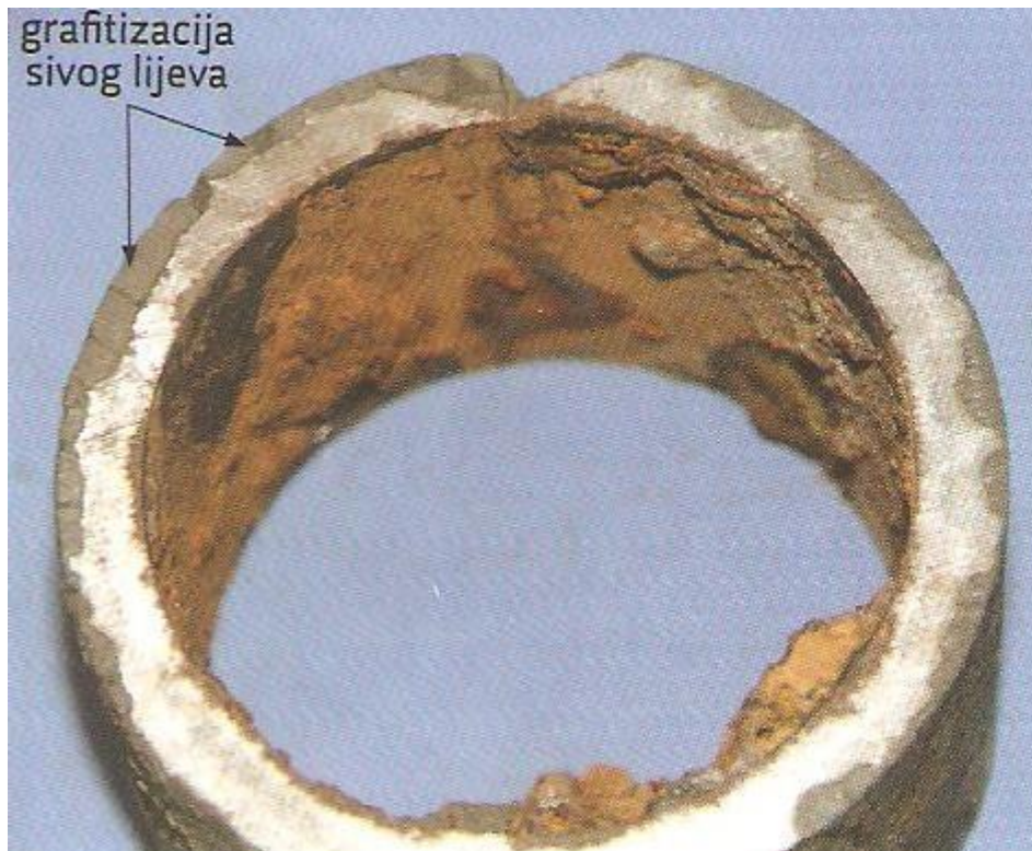
Slika 14 - Selektivna korozija vodovodne cijevi nakon 35 godina u tlu
