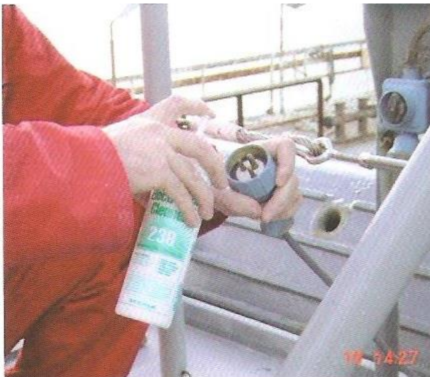
Slika 19 - Zaštita električnih kontakata
