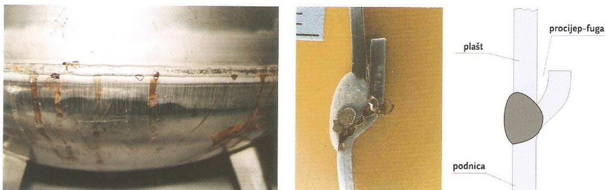
Slika 11 - Korozijska u procijepu na spremniku za vodu
