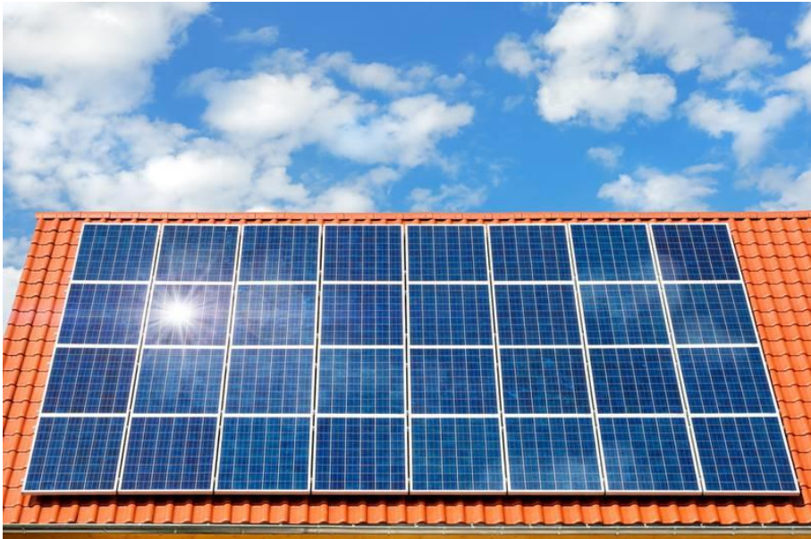
Slika 12. Solarni fotonaponski paneli na krovu
