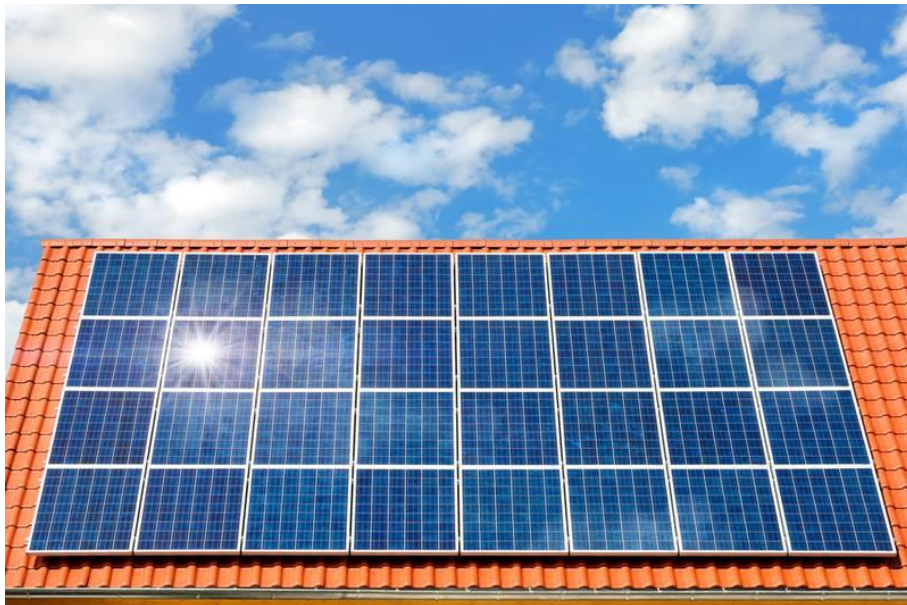
Slika 12. Solarni fotonaponski paneli na krovu
