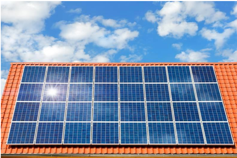
Slika 12. Solarni fotonaponski paneli na krovu
