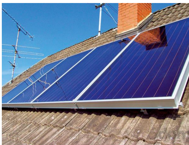
Slika 3.1.5. Solarni kolektori na krovu
