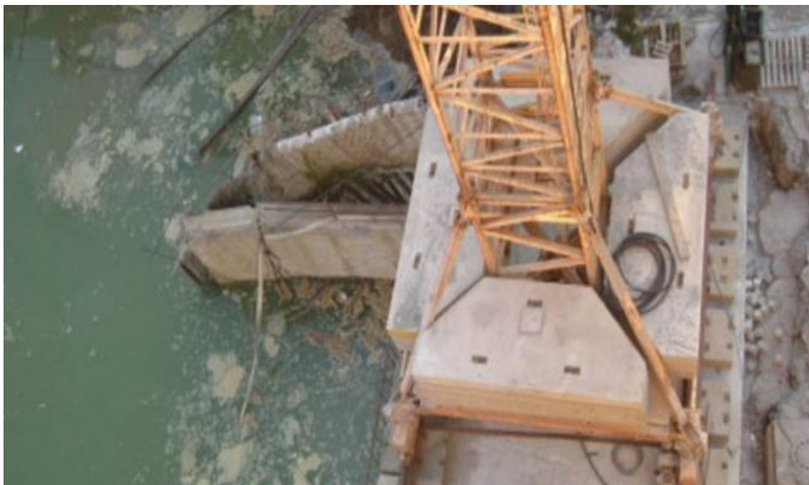
Slika 16. Urušavanje objekata i građevinske jame
