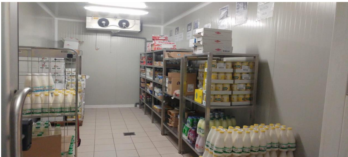
Slika 5.5. Rashladna komora poslovnice Super konzum Ivanec
