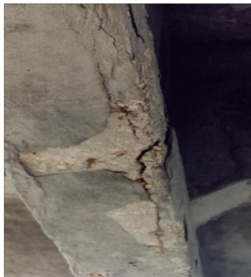
Slika 3.12. Primjeri oštećenja prilikom korozije
