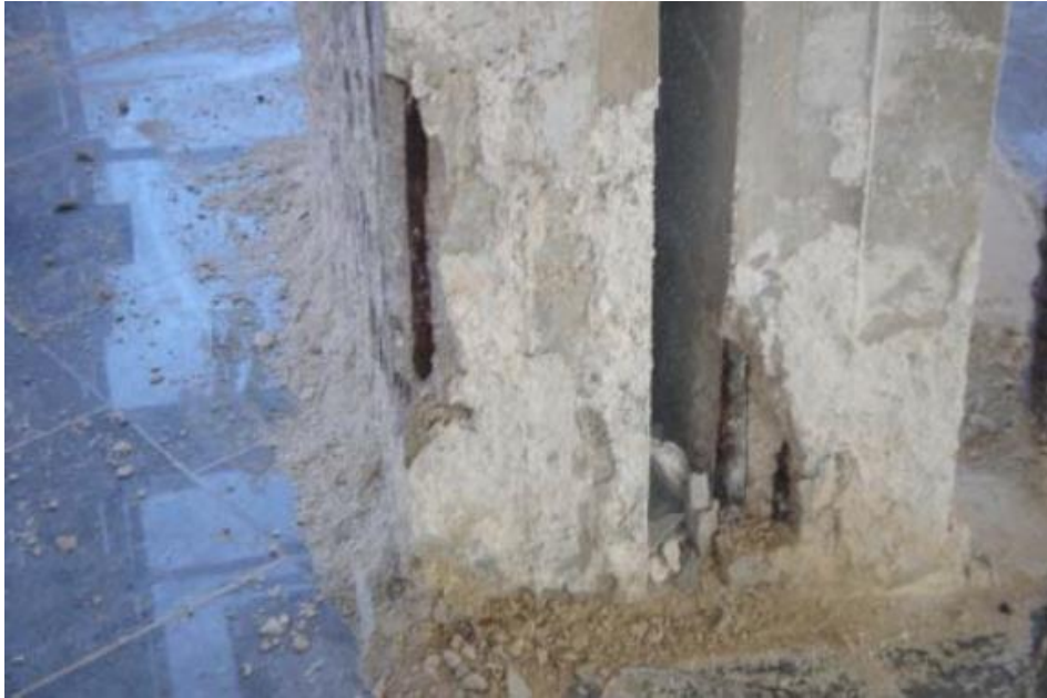
Slika 3.1. Uočeno oštećenje stupa na staroj zgradi
