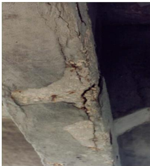
Slika 3.12. Primjeri oštećenja prilikom korozije
