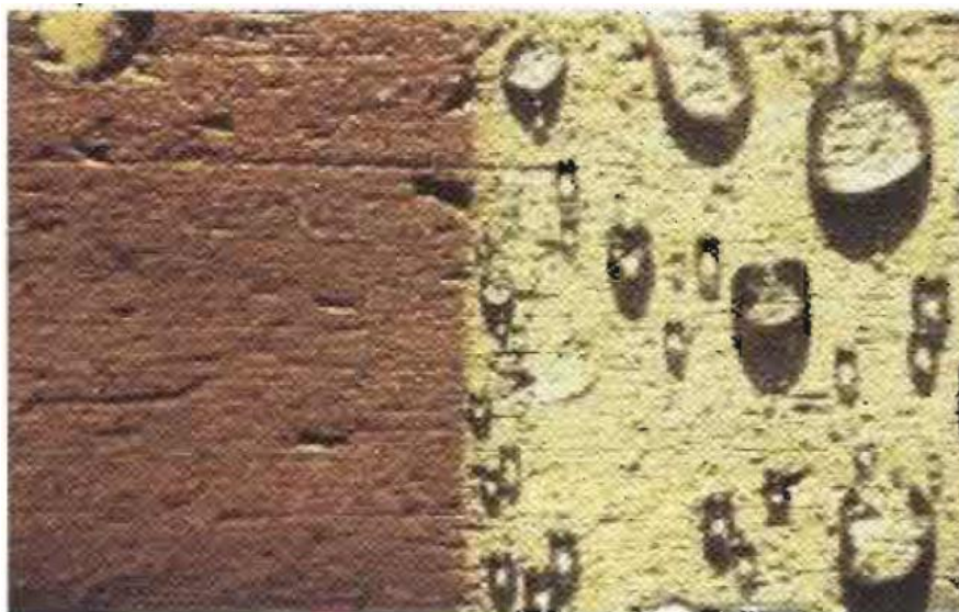
Slika 4.12. Usporedba površine koja nije zaštićena i površine tretirane hidrofobnom impregnacijom
