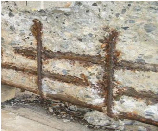
Slika 3.16. Vidljivo potpuno odvajanje zaštitnog sloja
