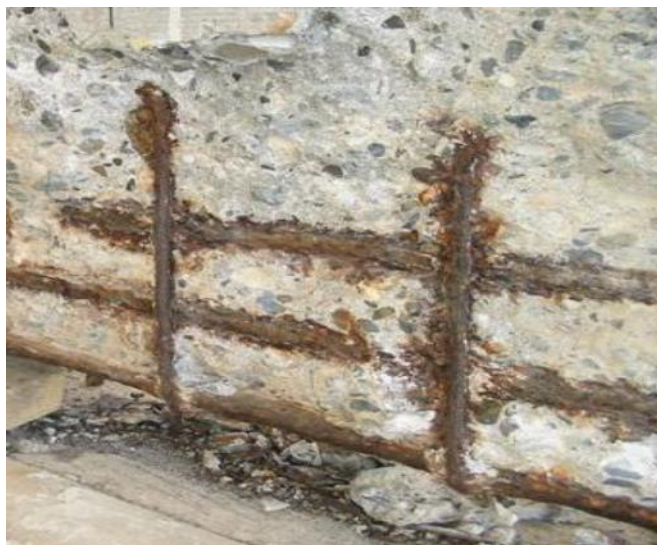
Slika 3.16. Vidljivo potpuno odvajanje zaštitnog sloja
