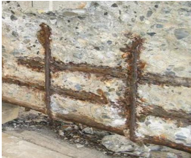
Slika 3.16. Vidljivo potpuno odvajanje zaštitnog sloja
