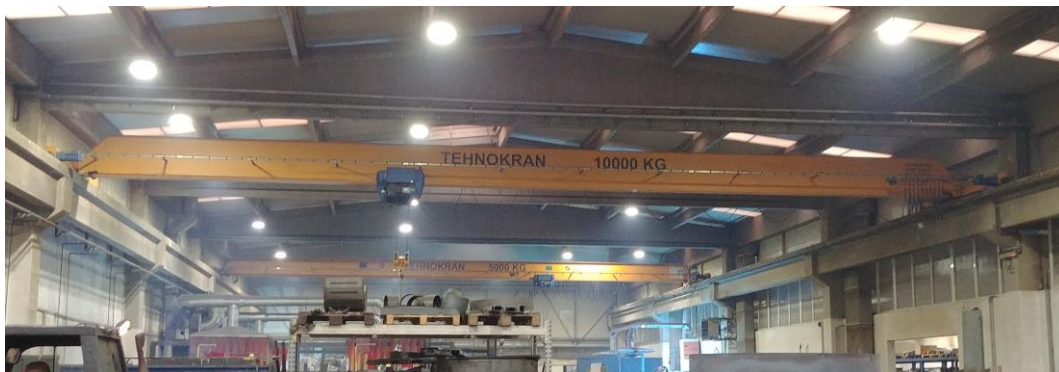
Slika 4. Kranovi u zavarivačkoj radionici
