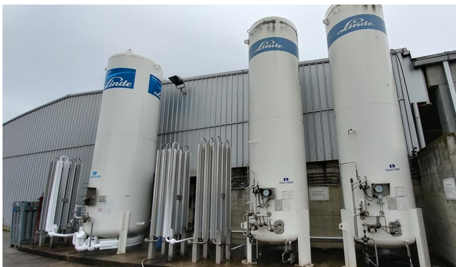
Slika 25. Vanjski spremnici tehničkih plinova
