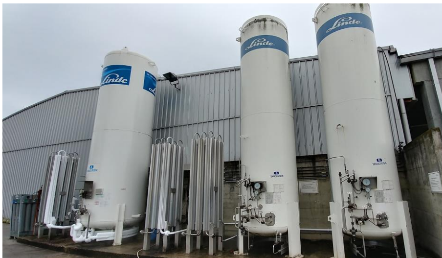
Slika 25. Vanjski spremnici tehničkih plinova
