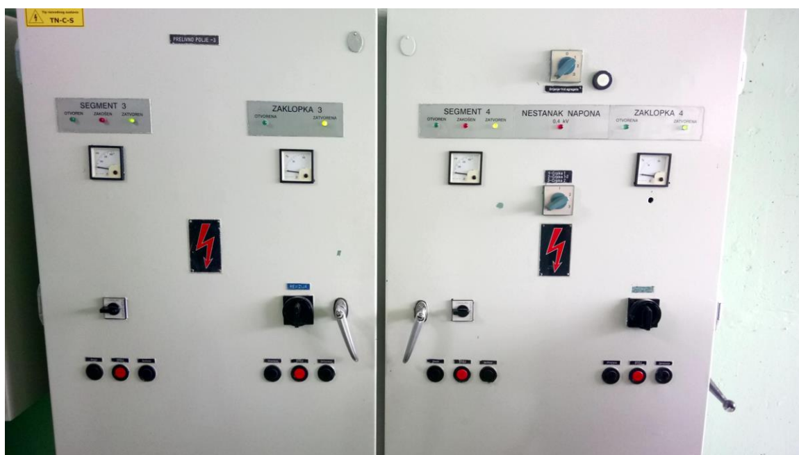
Slika 2.14. Upravljački ormari preljevnih polja
