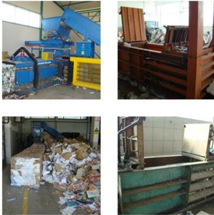
Slika 10. Elevatori i preše za obradu otpada, Izvor: Izradio autor
