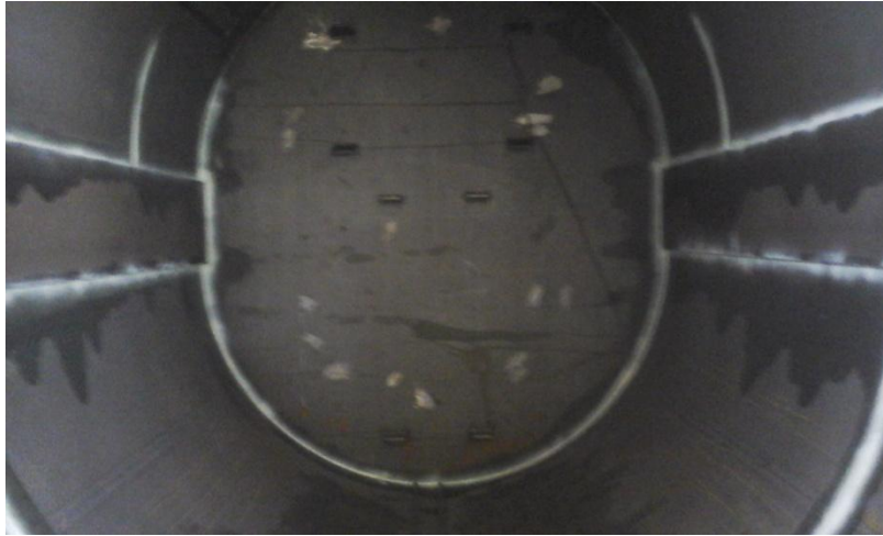
Slika 4.1.7 Unutarnji dio transformatorskog kotla
