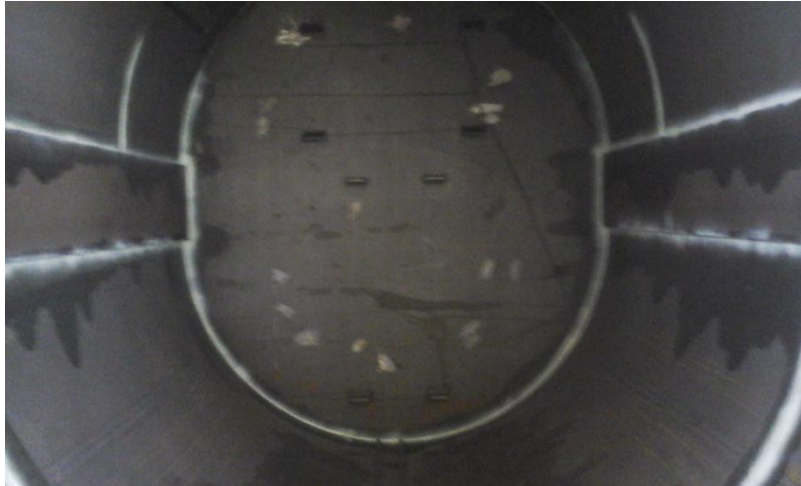
Slika 4.1.7 Unutarnji dio transformatorskog kotla
