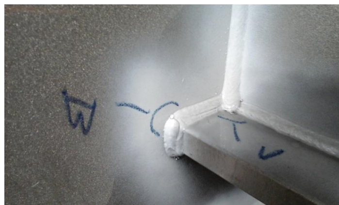
Slika 4.2.3 Navar (desno - oznaka V) zbog premalog unosa topline i neobrađeni završetak zavara ( lijevo – oznaka B)
