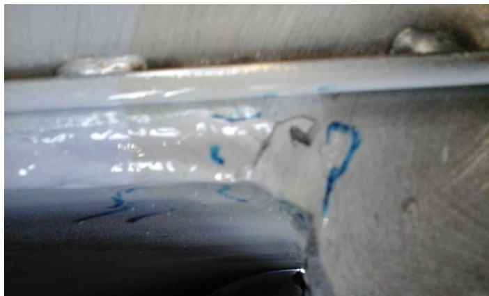
Slika 4.2.13 Transverzalna pukotina + poroznost
