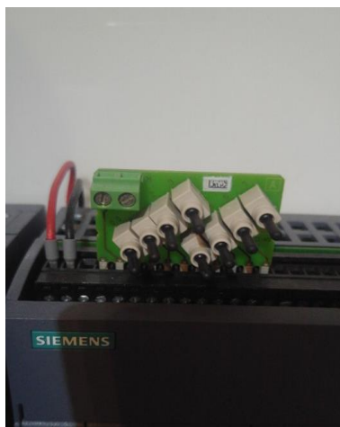
Slika 5.22 Digitalni ulazi PLC-a
