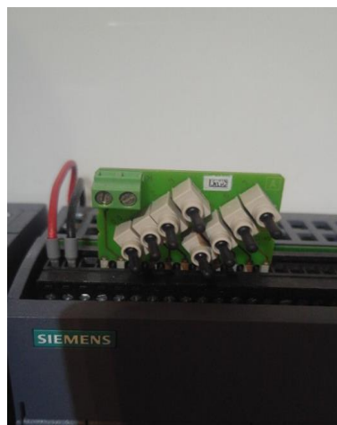
Slika 5.22 Digitalni ulazi PLC-a
