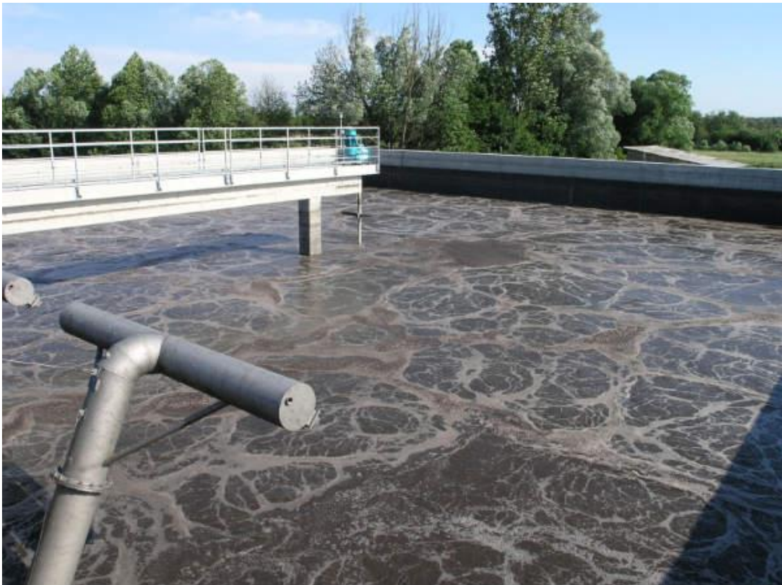
Slika 3.3.1.: Uređaj za pročišćavanje voda
