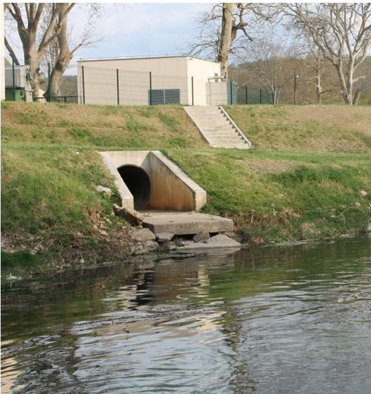
Slika 3.4.2.: Ispust u rijeku Krapinu
