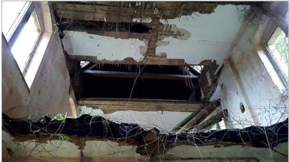
Slika 5.3. Spaljeni stropovi u dvorcu Opeka
