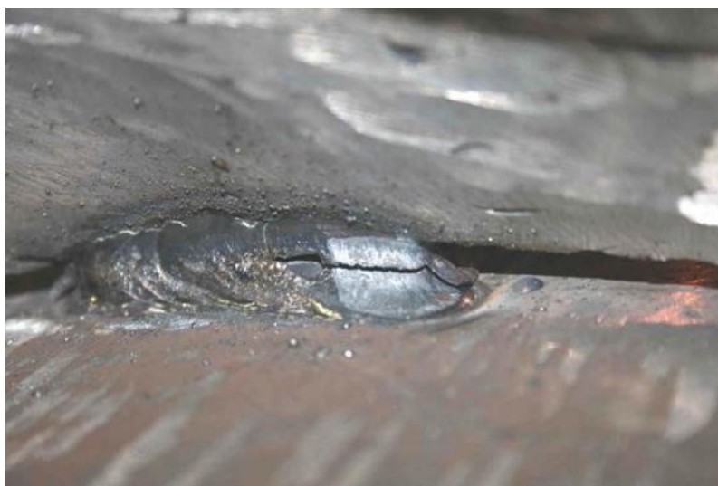
Slika 35. Pukotina u pripojnom zavaru
