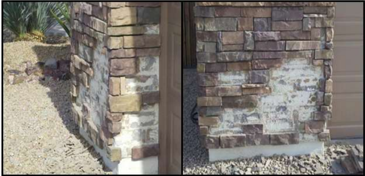
Slika 13. Popuštanje vezivnog sredstva između kamene ploče i konstrukcije
