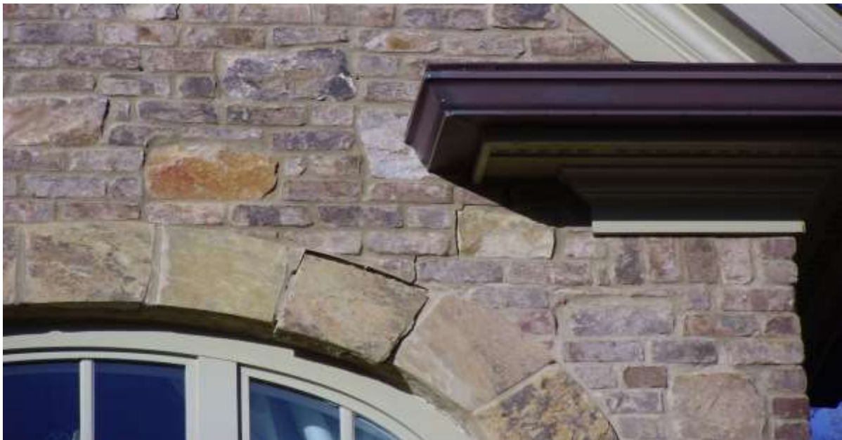
Slika 14. Pojava pukotina na kamenoj fasadi
