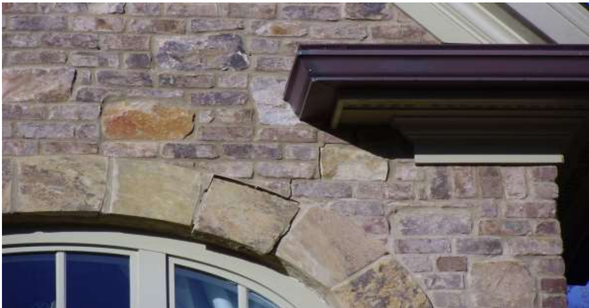
Slika 14. Pojava pukotina na kamenoj fasadi
