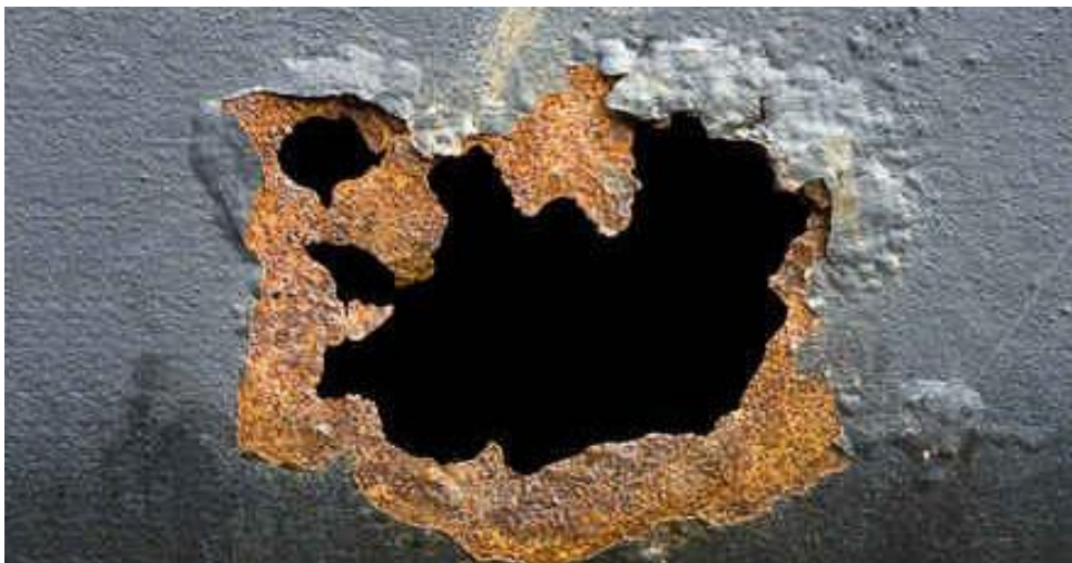
Slika 1. Pukotina nastala djelovanjem korozije na ugljičnom čeliku [13]
