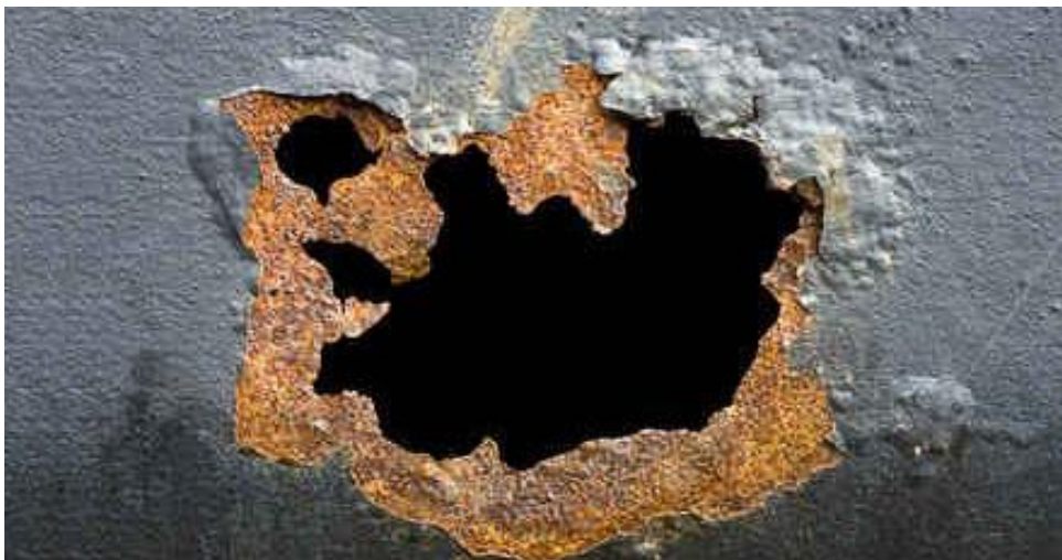
Slika 1. Pukotina nastala djelovanjem korozije na ugljičnom čeliku [13]
