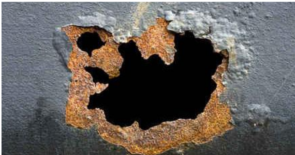
Slika 1. Pukotina nastala djelovanjem korozije na ugljičnom čeliku [13]
