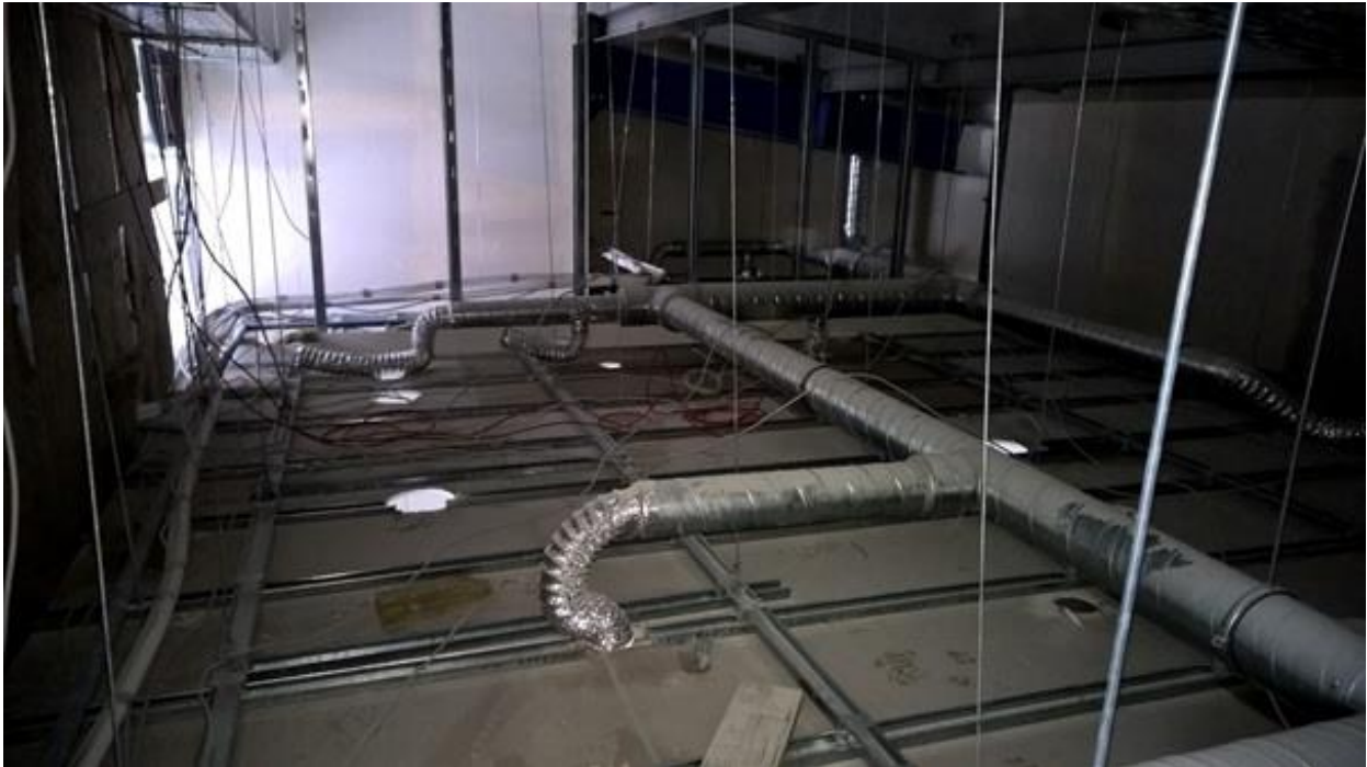
Slika 5.11. Mogućnost prikrivanja instalacija
