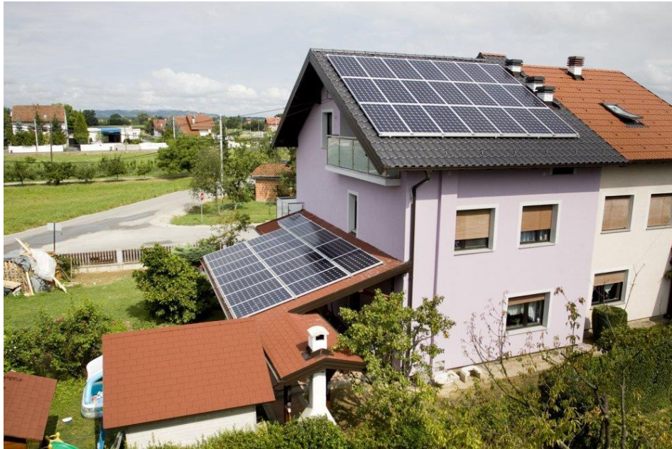
Slika 5.2. Fiksno postavljeni solarni paneli na krovu kuće [50]
