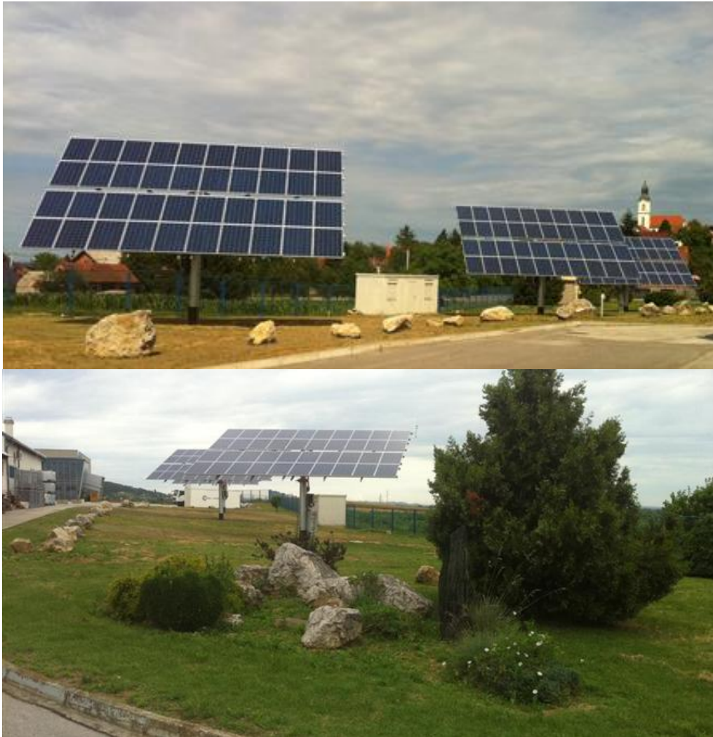
Slika 5.6. Tracker solarna elektrana u Svetom Iliji snage 25,2 kW [15]
