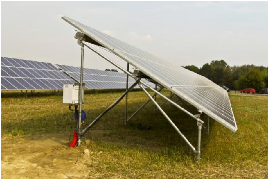
Slika 5.4. Fotonaponska elektrana FNE Orahovica 1 [13]
