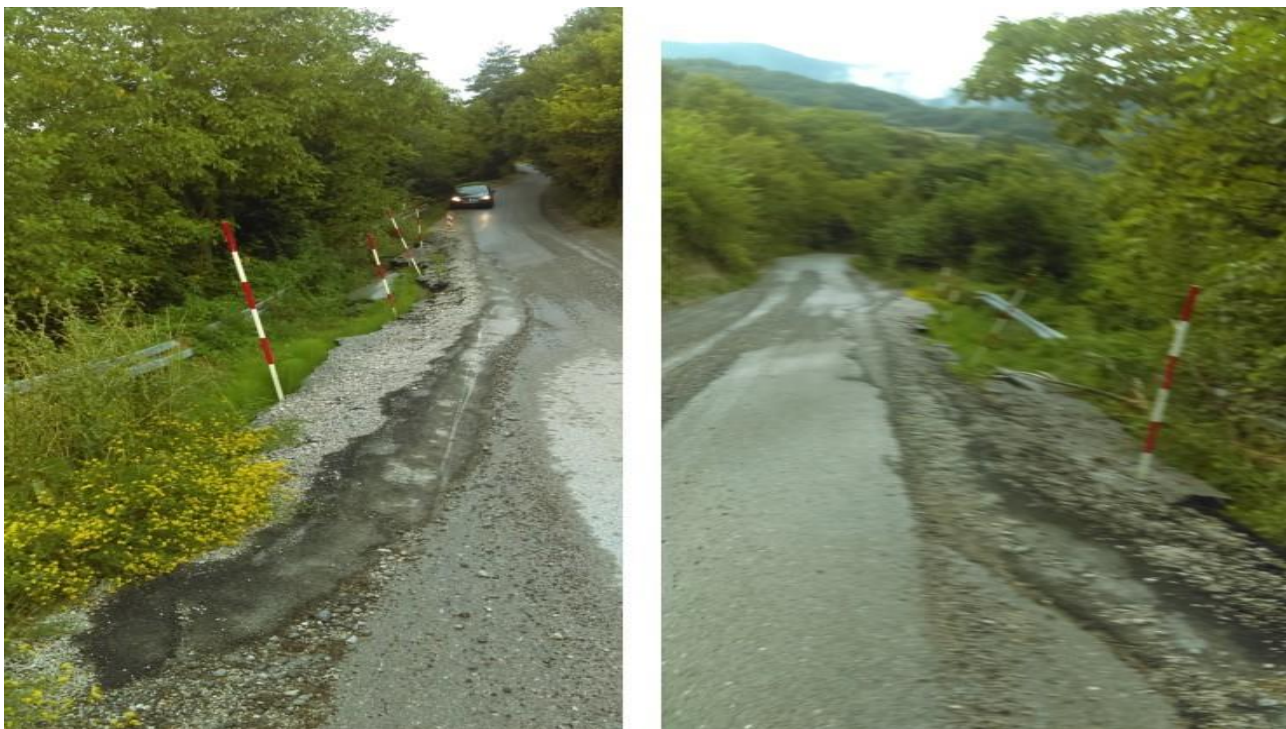
Slika 12. Klizište u Vranov Dolu
