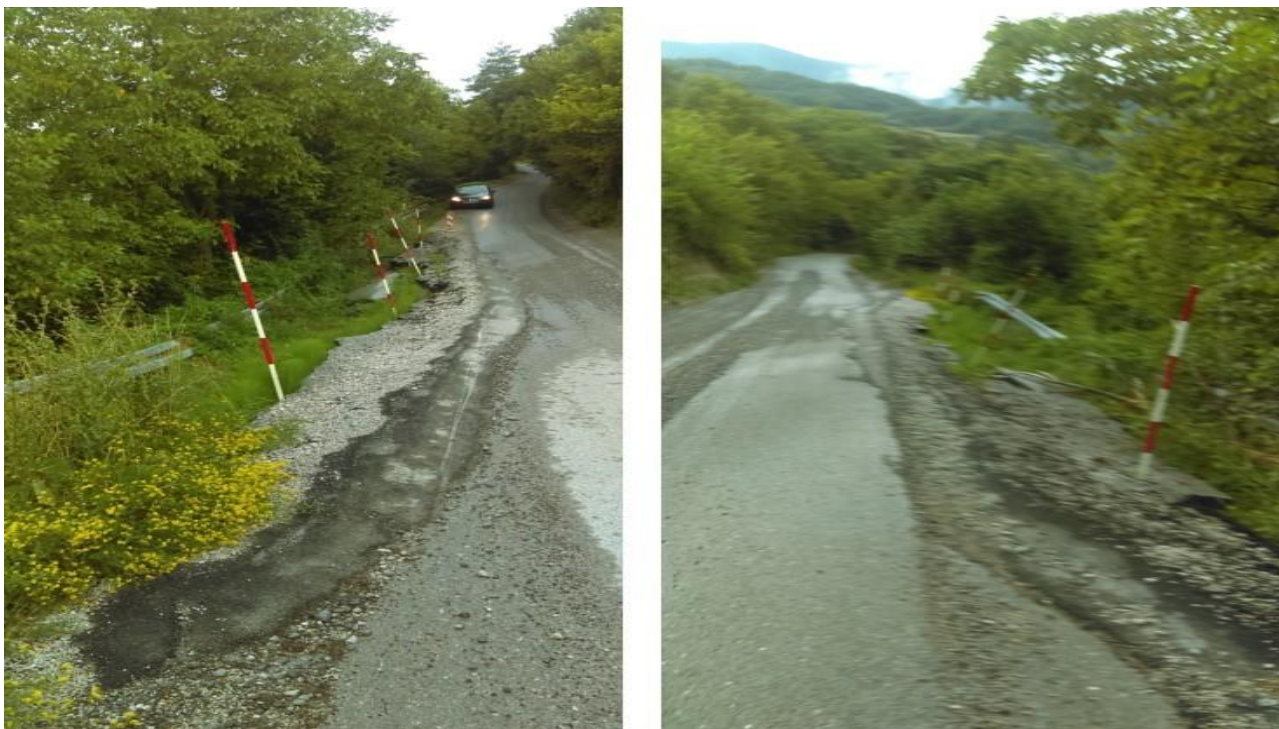
Slika 12. Klizište u Vranov Dolu
