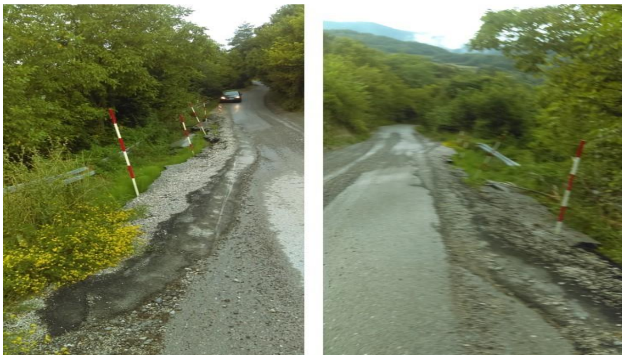
Slika 12. Klizište u Vranov Dolu
