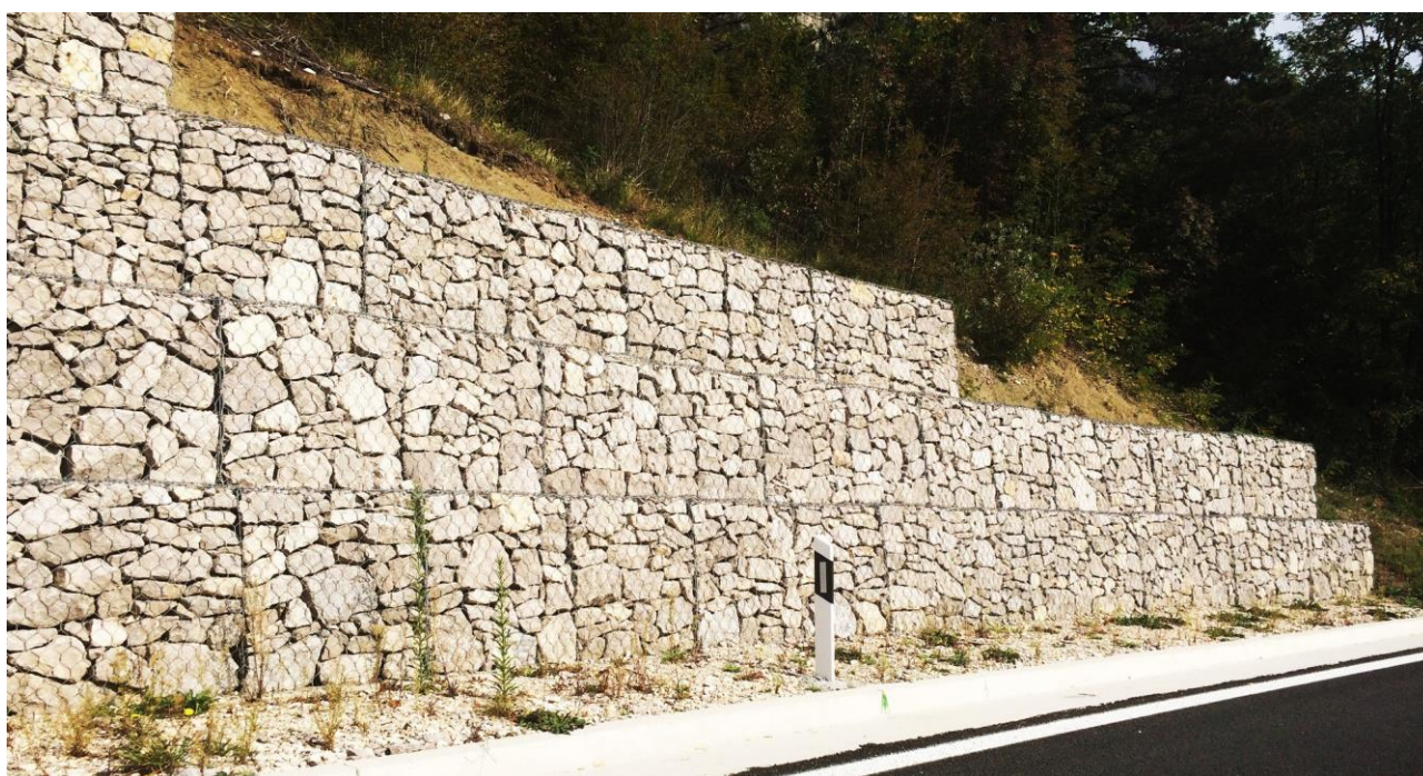
Slika 10. Potporna konstrukcija koja se koriste za bočno pridržavanje tla uslijed denivelacije terena, za osiguranje pokosa, usjeka ili zasjeka te povećanja stabilnosti kod klizišta i odrona
