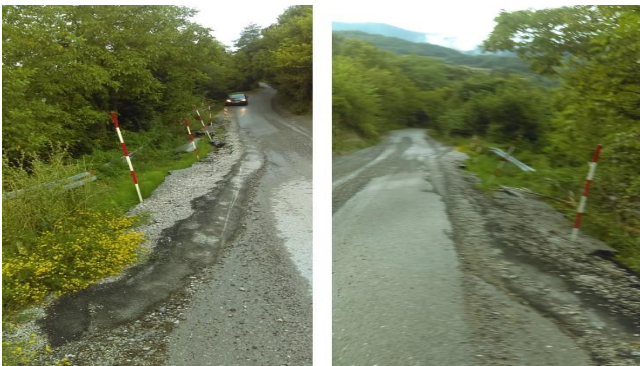
Slika 12. Klizište u Vranov Dolu
