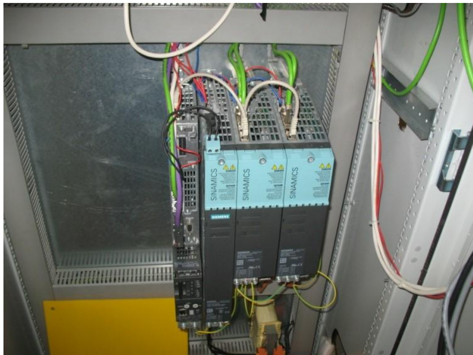
Slika 3.2. Unutrašnjost elektro ormara [20]
